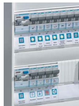
Repérage des circuits dans les coffrets
