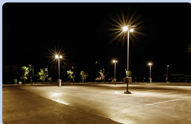
Exemple d'utilisation du projecteur 100 W 3000 K, monté sur mât.
